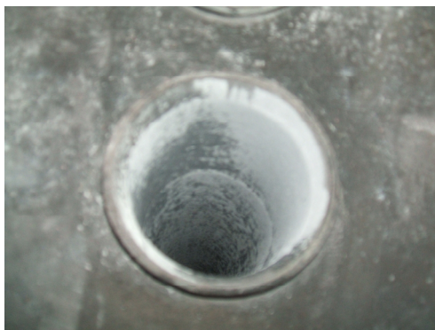
スケール溶解除去剤使用前
